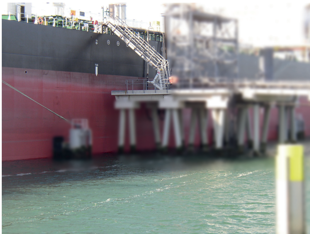
Рисунок 4: Рабочая зона трапа не подходит для безопасной эксплуатации
